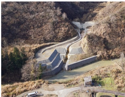
土木施工物件： 南平アシ沢外砂防堰堤工事(十二平川工区)
